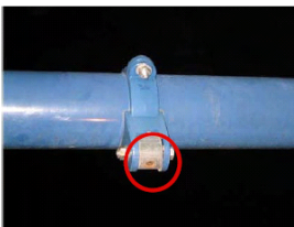
▲ 吊金具の破損、チェーンの脱落
