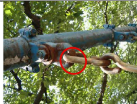
▲ 吊金具の摩耗
