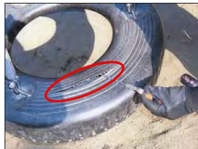
▲ 座面（タイヤ）の破損
