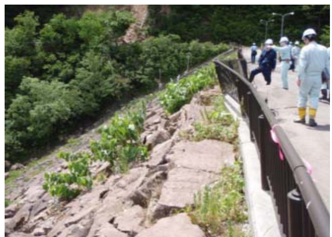
下流側法面 被災状況
