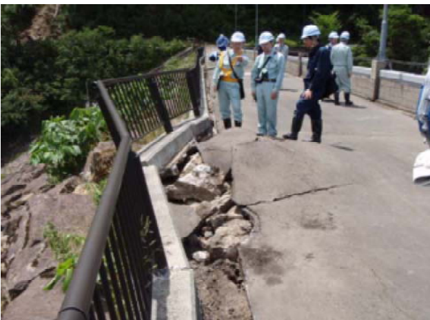
天端 被災状況
