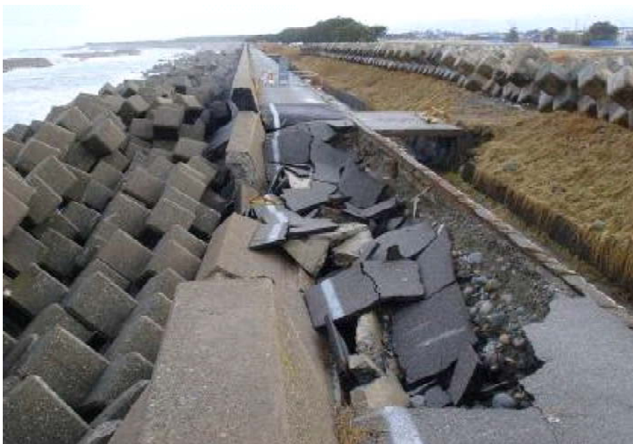
激しい高波により海岸堤防等が倒壊
