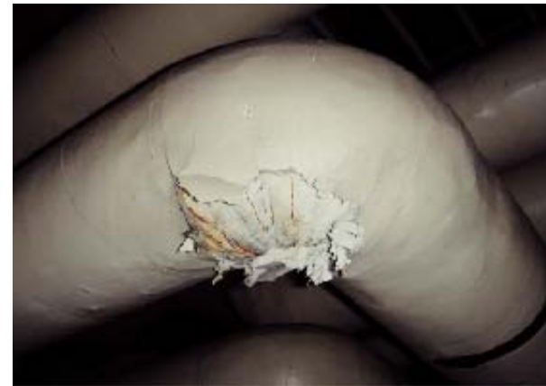
配管エルボの保温材①
