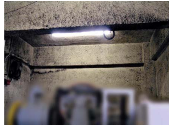
機械室 吸音材
