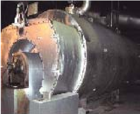
ボイラー の保温材
