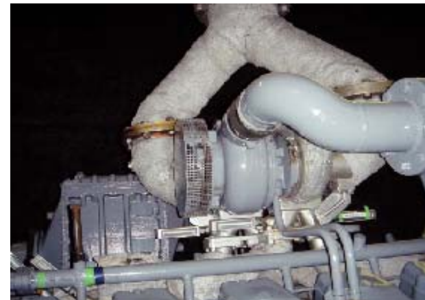
配管エルボの保温材②
