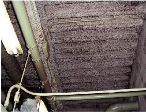
天井断熱材 天井、壁吸音材
