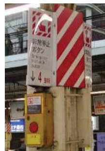
非常停止押しボタン
