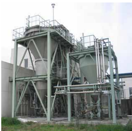
島根県宍道湖東部浄化センター
