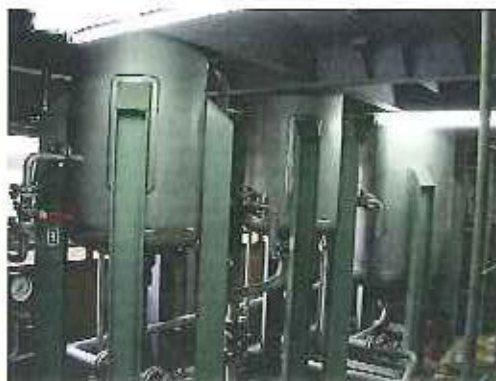
消化汚泥のオゾン処理による消化促進と汚泥減量化 Ozone treatment to promote digestion and sludge reduction
