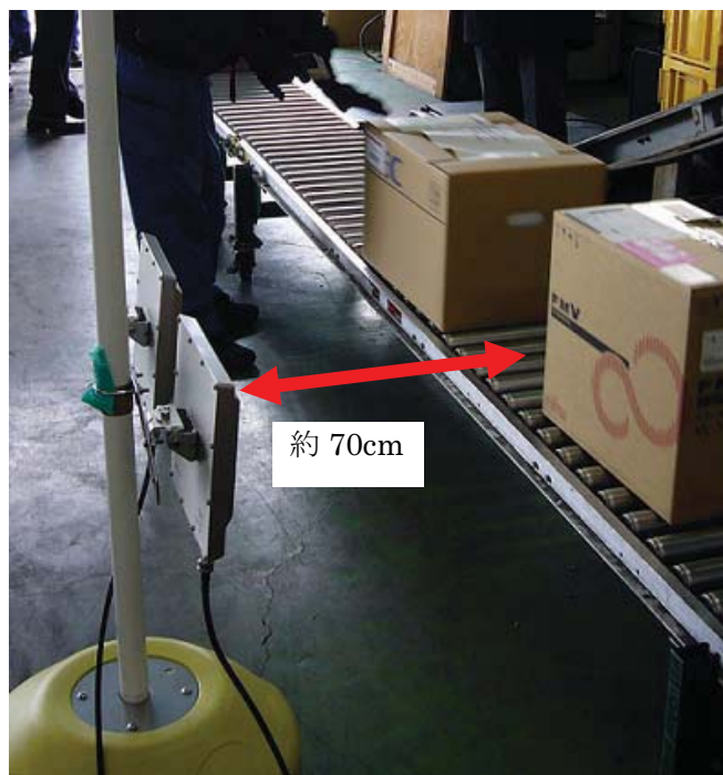
図 2-7 4 KWE 九州上屋における据置型 R/W 設置
