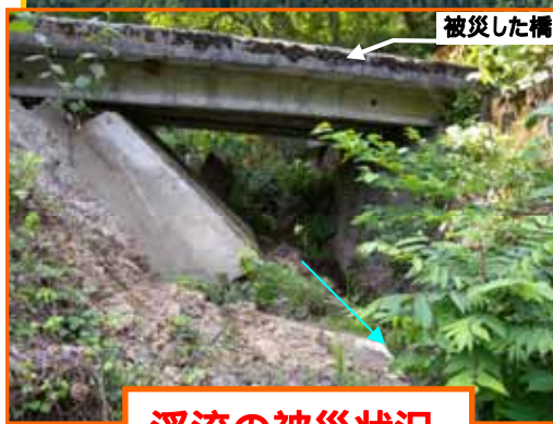
溪流の被災状況
