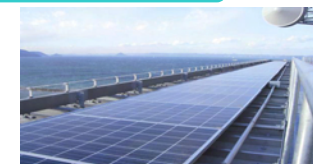
太陽光発電設備
