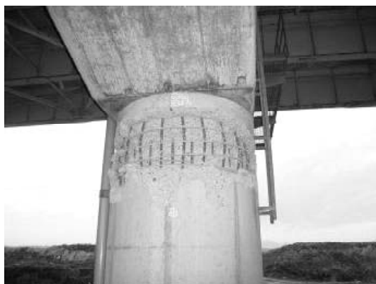
【地震により損傷を受けた橋梁の例】
