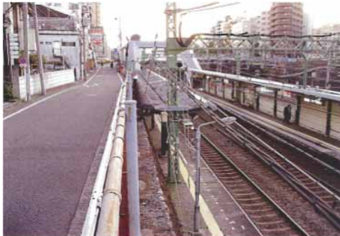
ホームが狭隘で、さらに両側を道路と他社鉄道に挟まれ拡幅も困難な例
