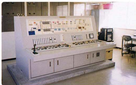
排水処理施設 中央監視操作室
