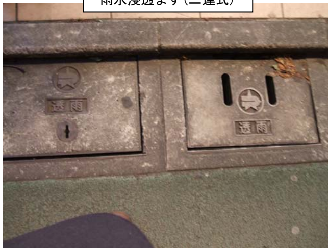
雨水浸透ます(二連式)
