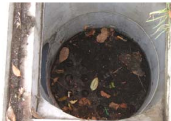
写真 7-1 浸透ます底部が土砂で覆われた状態
