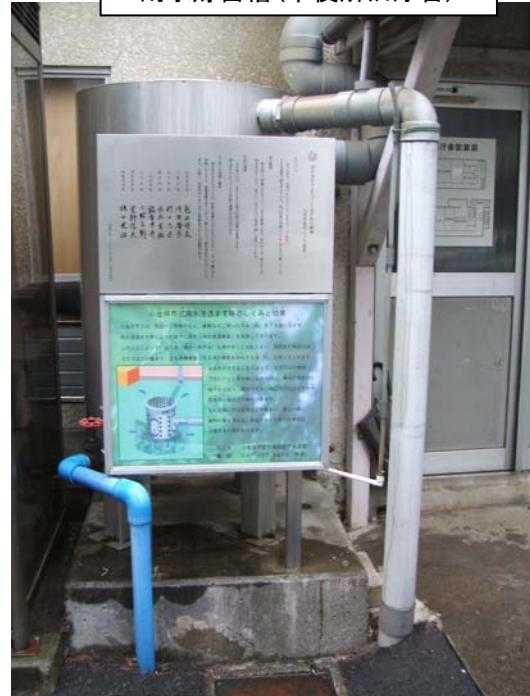
雨水貯留槽(市役所旧庁舎)
