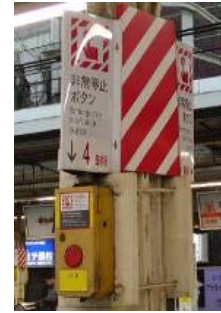
図3:非常停止押しボタン
