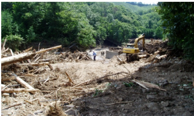
流出した土砂で道路が埋塞
