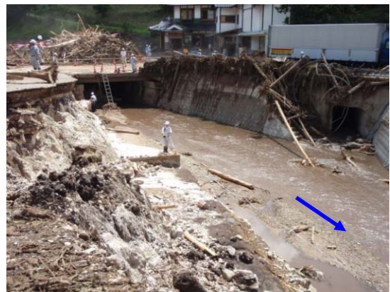
既設のコンクリート護岸が崩壊
