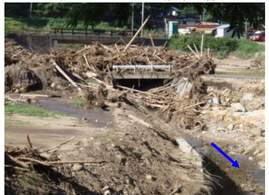
橋梁に流木や土砂が堆積し、氾濫を助長
