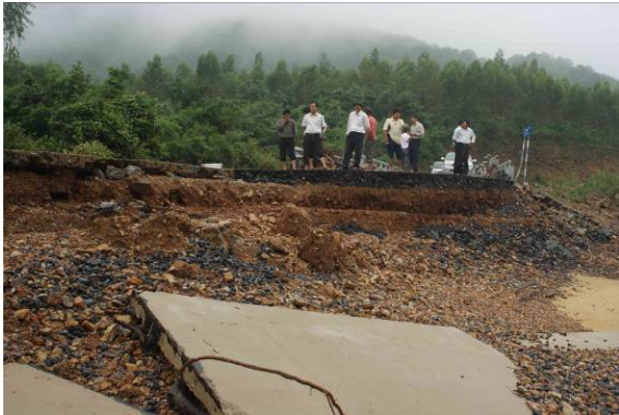
山間部との連絡道路兼用堤防の流出
