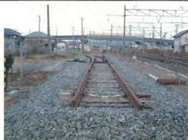
軌道設備全体
