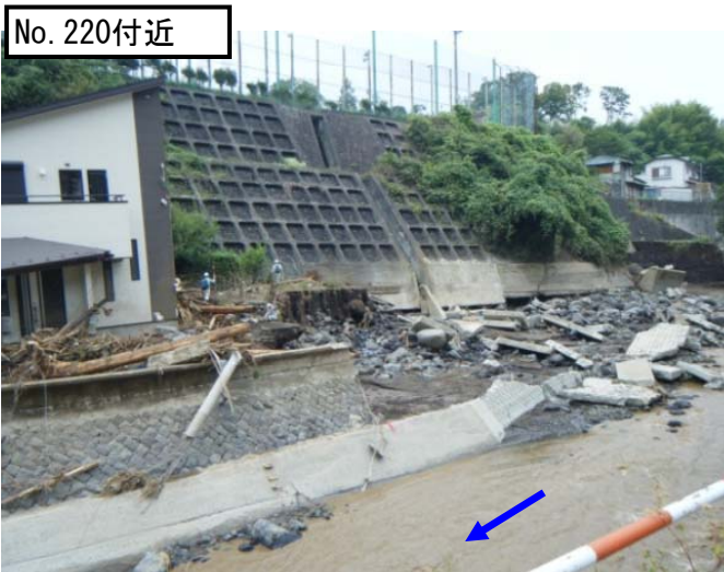
洪水により護岸が倒壊
