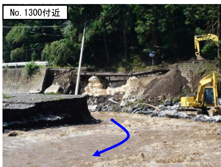
護岸が倒壊し、隣接する町道も崩落
