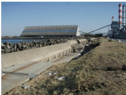
陸側が洗掘 (写真:八戸港海岸八太郎地区)
