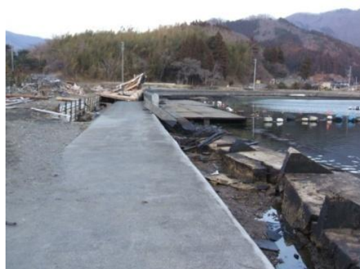
堤体が海側に倒壊 (写真:大船渡港海岸永浜地区)
