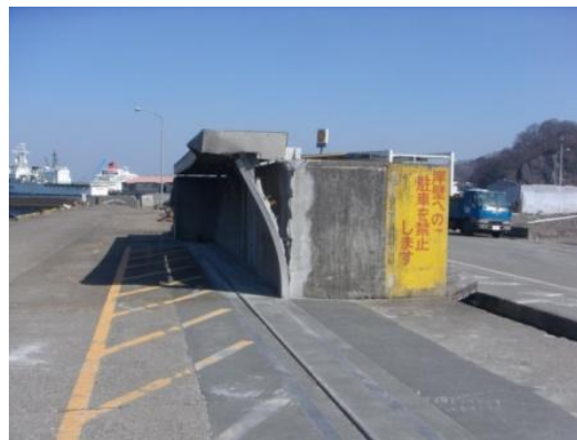
陸閘が海側に破損・流出 (写真:釜石港海岸須賀地区)
