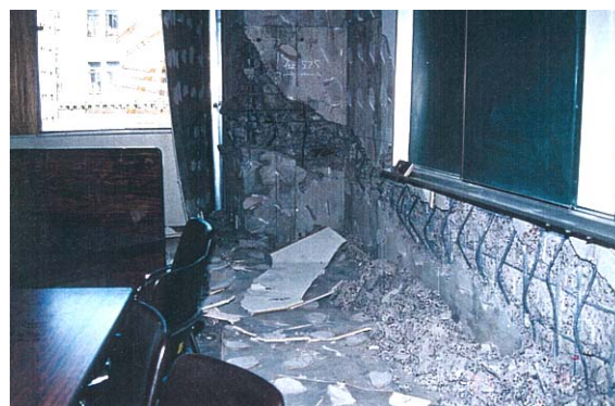
内部の被災状況
