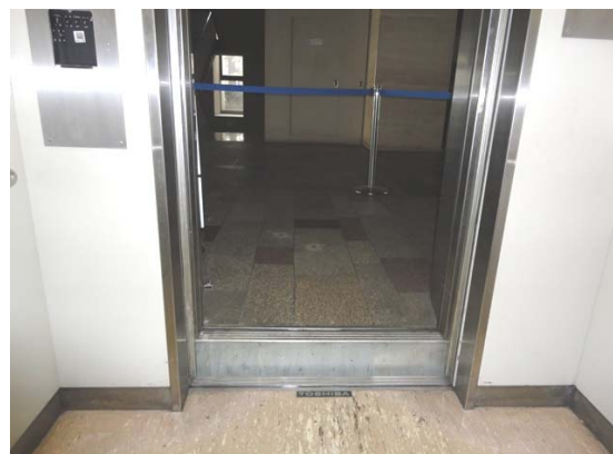
エレベーター着床時の段差
