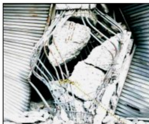
店舗1階柱の圧壊
