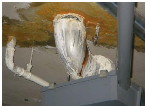
亀裂のある排水管
