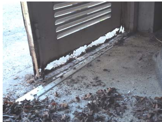
腐食した建具
