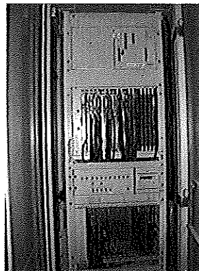
【変電所施設の一例】
