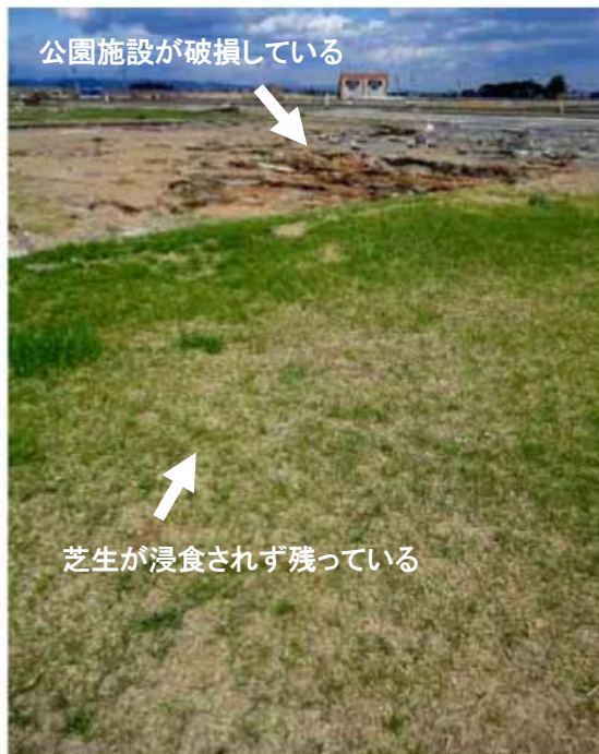
津波の越流により、公園施設は破損しているが、 裸地部分には芝生が残っている。 （宮城県亶理郡亶理町鳥の海地区）
