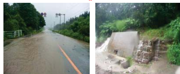
①被災状況(村上方面を望む) ②被災状況(山形方面を望む)
