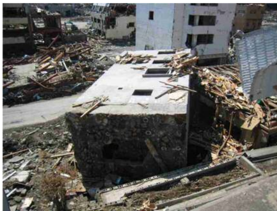
写真 2.3 転倒した杭基礎鉄筋コンクリート建築物 (OG-01)
