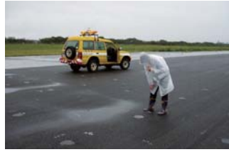
滑走路には鳥が落としたクルミなどが落下している場合もあり、吸い込むと機体にダメージを与える。日々の飛行場定時点検は欠かせない。
