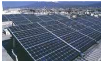
【太陽光発電設備】
