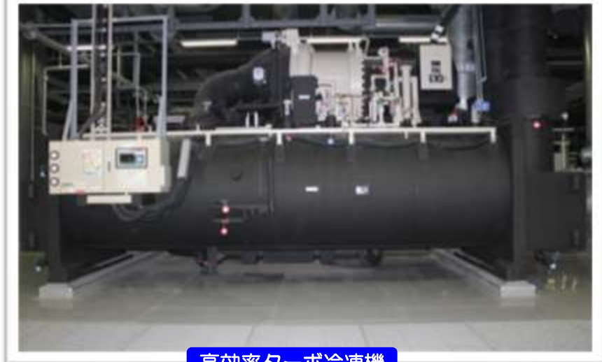
高効率ターボ冷凍機
