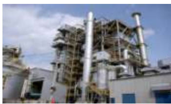
【バイオマス発電設備】
