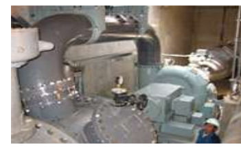
【水力発電設備】
