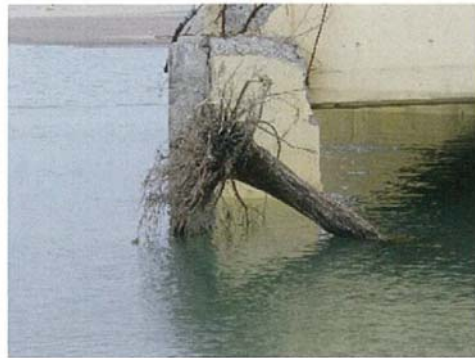
写真—3 杭根(ぐいね)の見られない浅根の被災木
