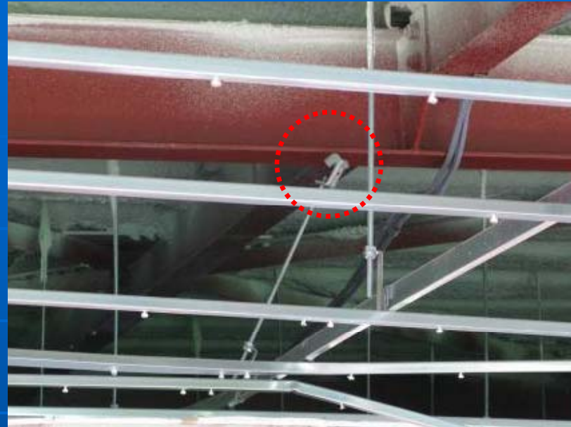
H形鋼梁への吊り金具の外れ
