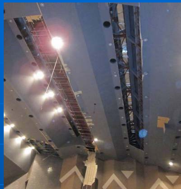
段差部・折り曲がり部
