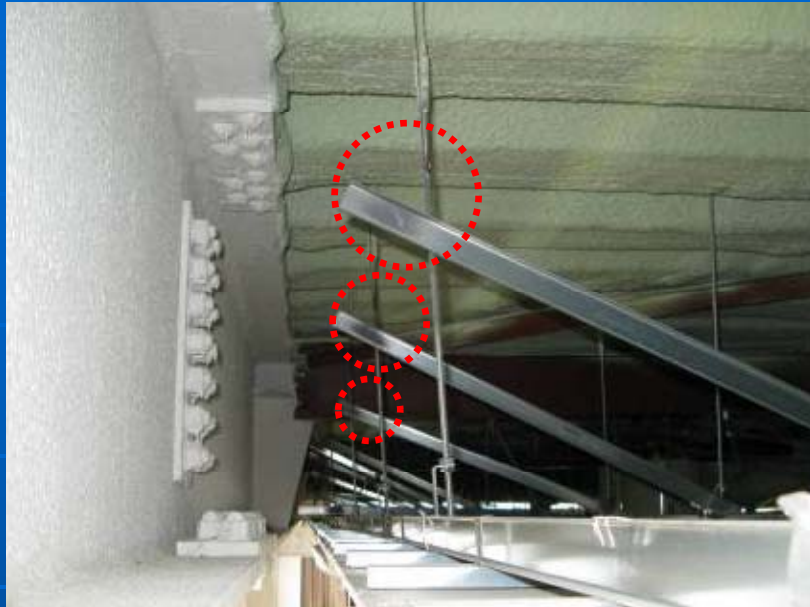
斜め部材の溶接の外れ
