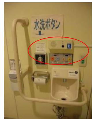
1階多機能トイレ内部の音声案内設備。建物完成後に視覚障害者の意見を反映して後付けされた）
