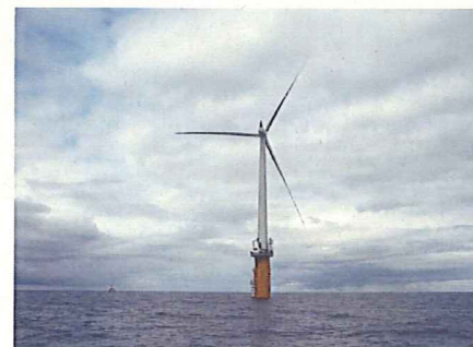
ノルウェー 設置時期: 2009年9月 発電機サイズ: 2.3MW
