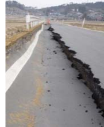
無対策箇所(被害大)
