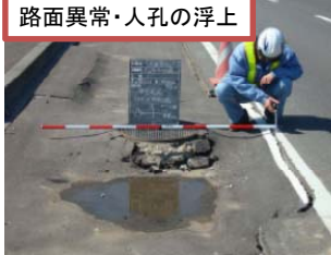
路面異常・人孔の浮上
