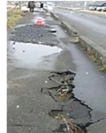
無対策箇所(被害大)
