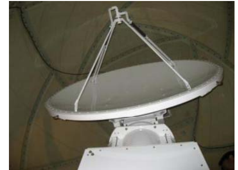
レーダアンテナ(埼玉サイト)
