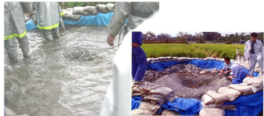
濁水が噴出している様子
