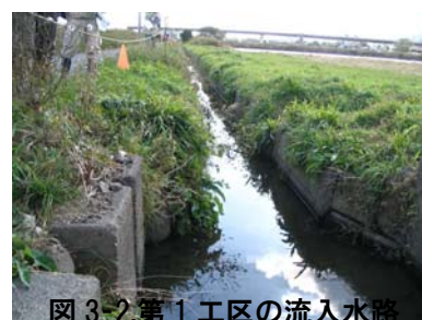
図 3-2.第1工区の流入水路
