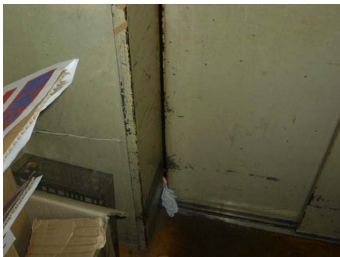
(写真 I - 1 2) 扉下端に軍手を挟んだ状態
