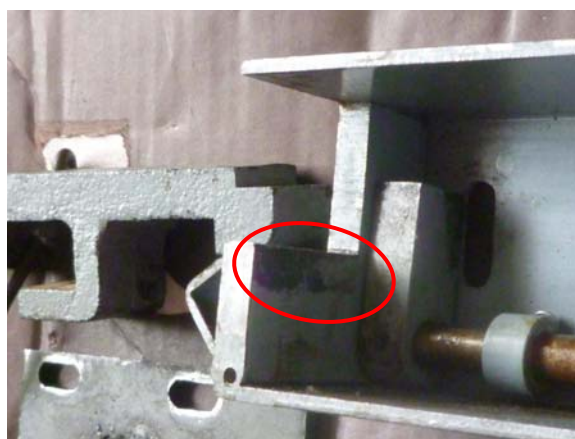
(写真 I-11) ラッチが当たる部分
