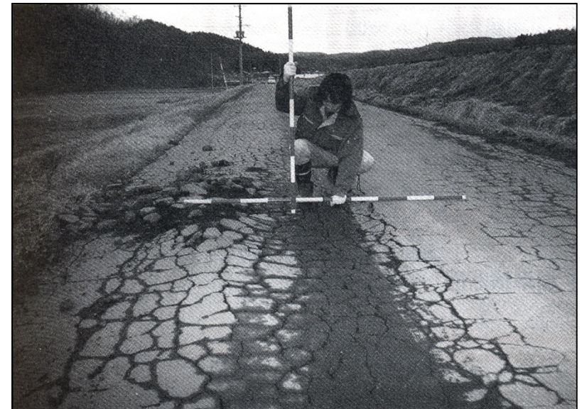
土の噴出と舗装面のクラック
