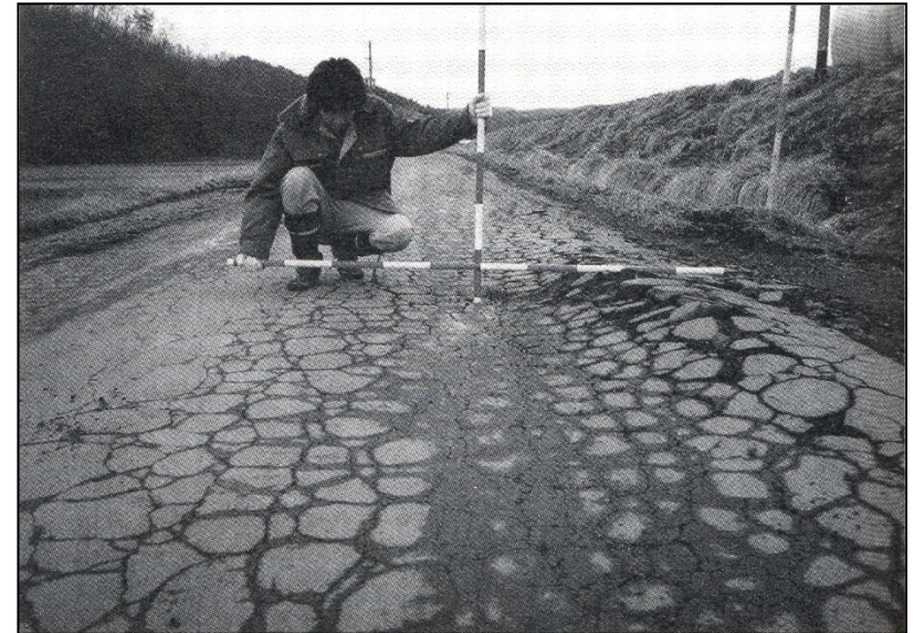
舗装面の盛り上がり、沈下
