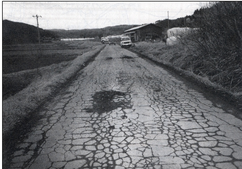
舗装剥離による穴
