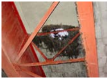
(橋梁の抜け落ち)
