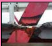
木曾川大橋斜材の破断 (2007)
