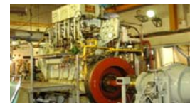
排ガス後処理装置
