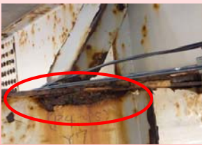
付着塩分による鋼橋の深刻な腐食
