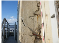
水門の門柱部のコンクリ剥離
