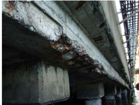
鉄筋腐食によるコンクリート剥落
