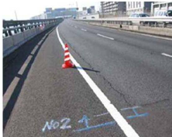
矢板変位による路面ひび割れ
