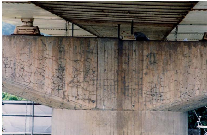
アルカリ骨材反応による橋脚のひび割れ
