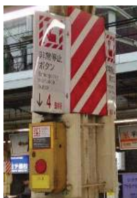
非常停止押しボタン
