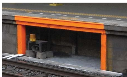
ホーム下の待避スペース
