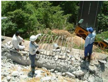
被災状況調査
