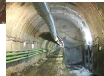
地すべりの動きを止めるための深礎杭施工、排水トンネルの設置
