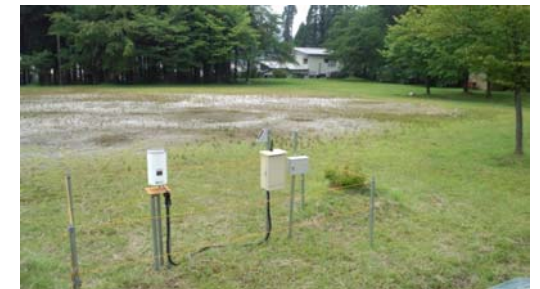
現地雨量計設置状況
