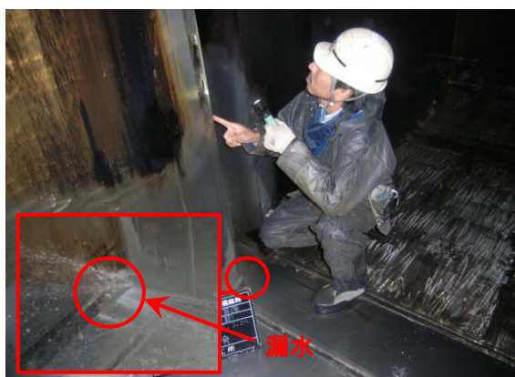
ゲート設備：扉体水密部からの漏水
