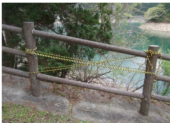
防護柵の欠損
