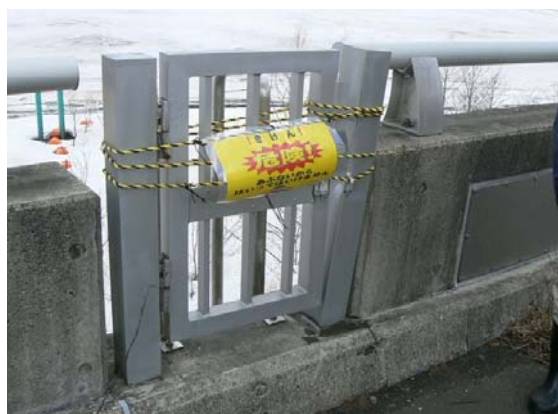
ダム天端進入扉の破損
