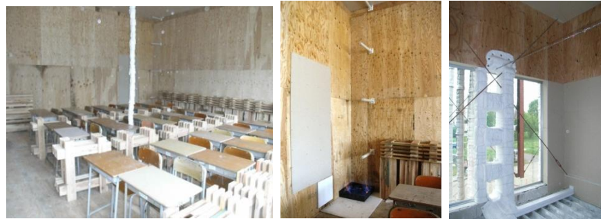
写真 1階内部 写真 火源近傍 写真 2階内部
