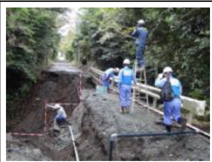
道路被災箇所の状況調査
