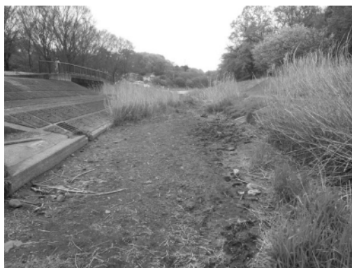
瀬切れした野川（第2調節池下流・平成21年度）
